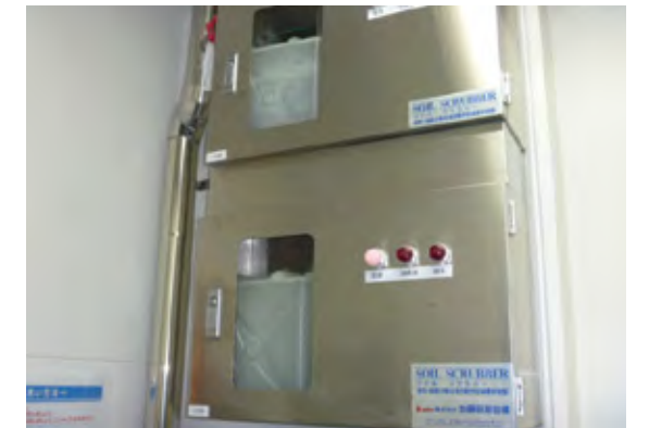
脱臭装置制御盤
